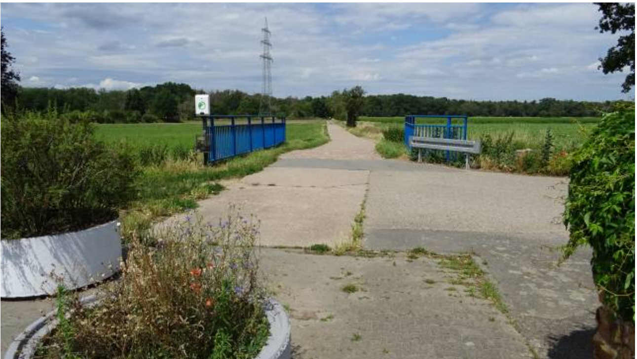
Brückenweg bis zum Wirtschaftsweg renovierungsbedürftig
